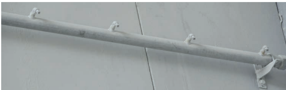
Rampes de pulvérisation d'eau au-dessus d'une trémie
