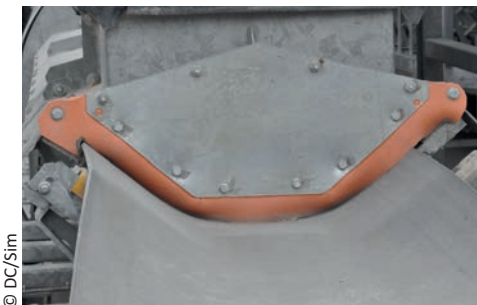
Bavettes d'étanchéité en partie basse d'une zone de chargement sur un convoyeur
