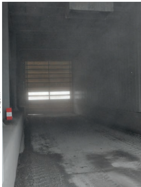
Hall de chargement en dépression après départ du véhicule
