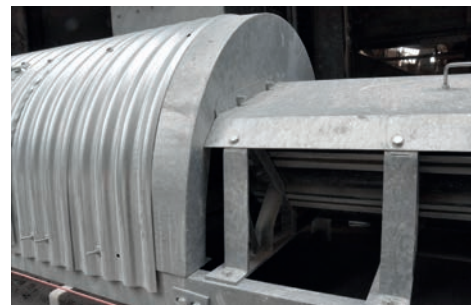
Détail de réalisation d'une liaison sur un convoyeur entre zone de chargement et zone de transport
