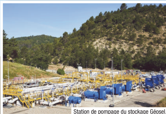
Station de pompage du stockage Géosel.
