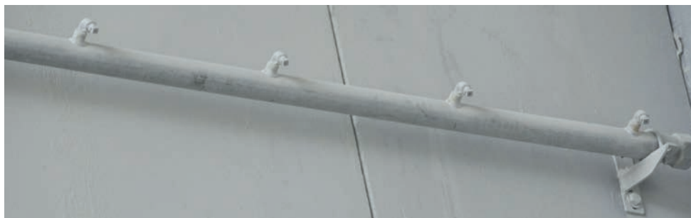
Rampes de pulvérisation d'eau au-dessus d'une trémie
